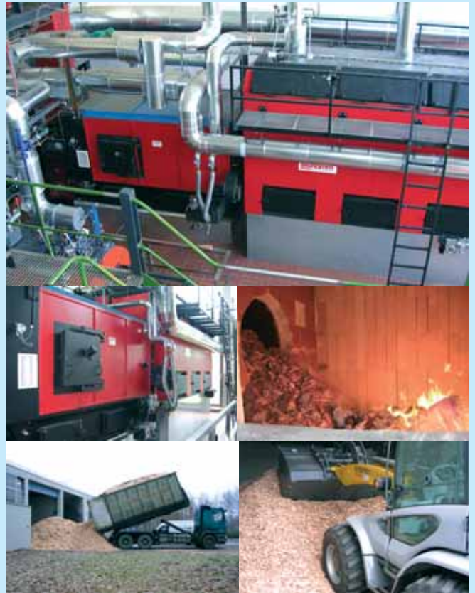
Holz hackschnitzelanlage in der Bundeswehrrsportschule Warendorf (oben und Mitte links), Feuerung (Mitte rechts), Anlieferung der Hackschnitzel (unten links) und Hackschnitzelbunker (unten rechts)
