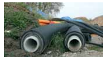
Kreishaus Steinfurt, Biogasanlage in Steinfurt-Hollich und Gas- und Nahwärmeleitungen für die Wärmeversorgung öffentlicher Einrichtungen (Bilder von oben nach unten)
